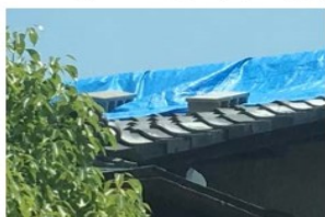
ブロック置いただけ 落下の危険性大
