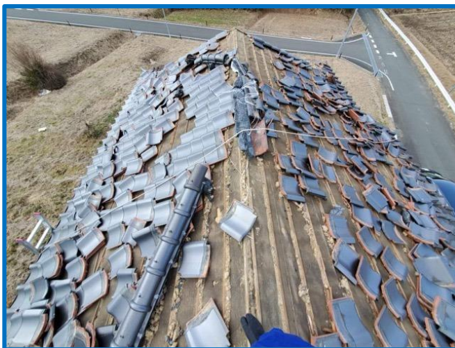
瓦の崩れから地震の大きさが想像される
