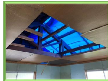
竜巻で屋根が飛び空が見える ブルーシートで応急処置
